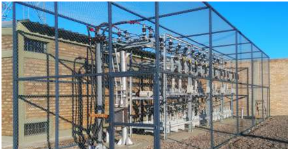
Energía San Juan S.A., San Juan
