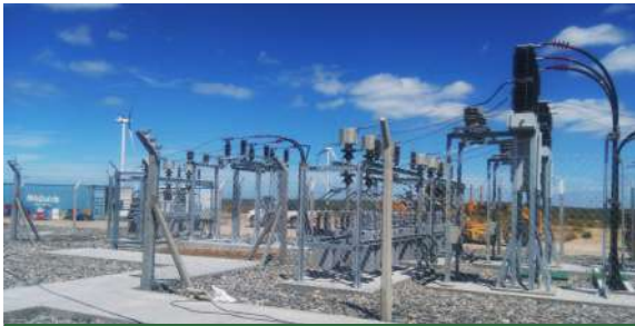
Energía San Juan S.A., San Juan
